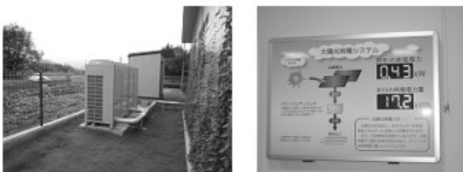
↑ 地下水ヒートポンプ（室外機）、スマートメーター（発電量のみ表示）を備えた青基地区センター
