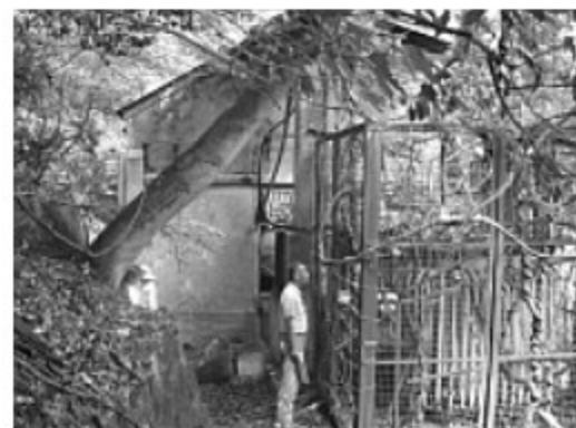
←大きな藤の絡む変電設備（手前右）と、発電所（奥）
