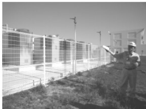
屋外に16台設置されている小型バイオガスコージェネ発電機
