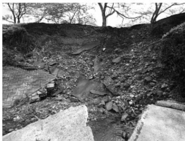
↑上石津町内の堤防破損箇所 あと少しで決壊するところでした
